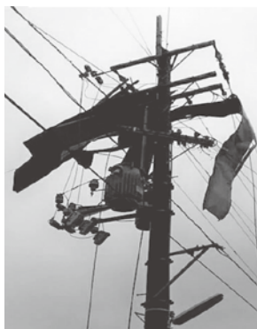
▲電柱に掛かったトタン
