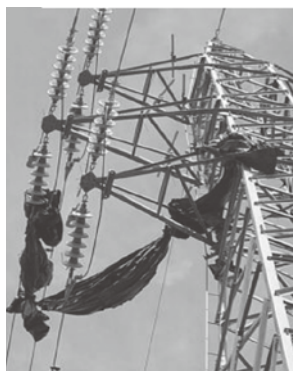
▲鉄塔に掛かったマルチシート
