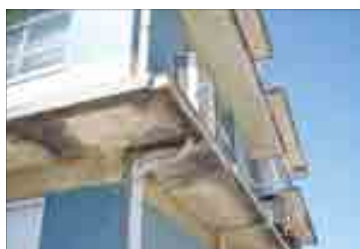
▲剥落した庇（東庁舎）
